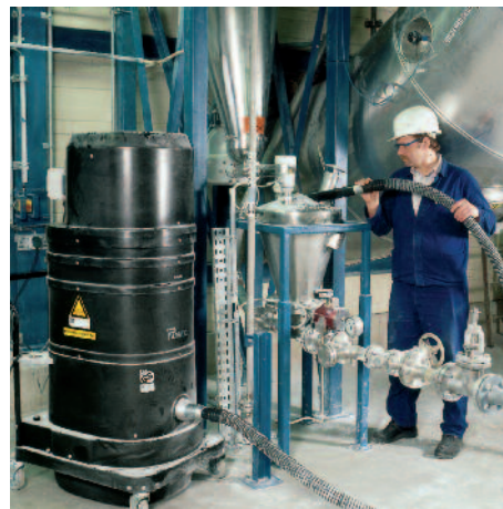
DS 2520 gas-Ex in chemical production
